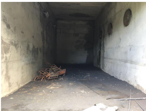
Vista interna da cabine de jato
